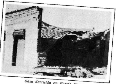
Casa derruida en Barrio Bravo. (Foto Masstev).
